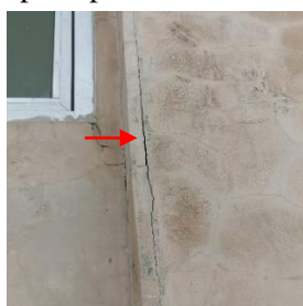
Gambar 2. Retak pada Kolom
