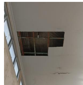
Gambar 3. Kerusakan pada Plafond
