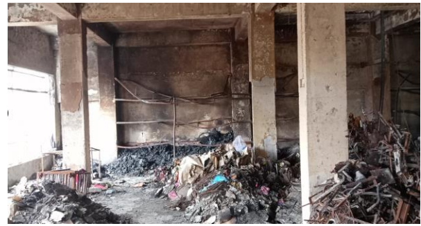
Gambar 2. Kondisi interior Gedung pasca kebakaran
