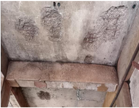
Gambar 4. Spalling pada pelat lantai Sumber: Dokumentasi lapangan (3 Juni 2024)
