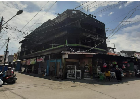
Gambar 1. Kondisi bangunan pasca kebakaran Sumber: Dokumentasi lapangan (25 Mei 2024)
