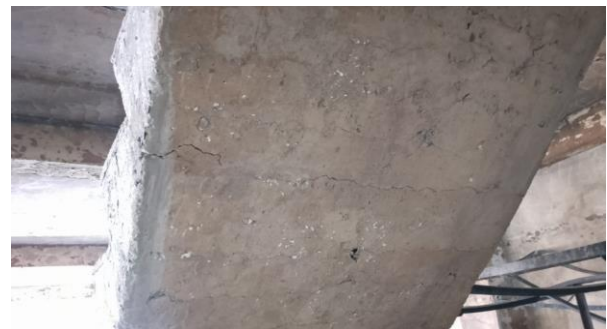
Gambar 6. Cracking pada tangga Sumber: Dokumentasi lapangan (3 Juni 2024)
