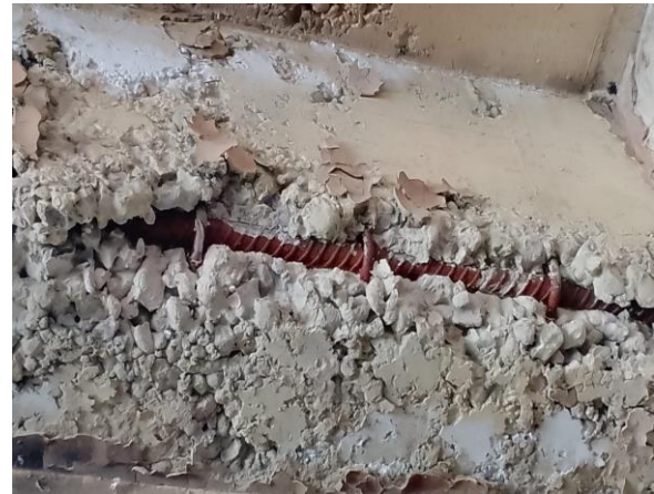
Gambar 3. Spalling pada balok serta korosi tulangan
