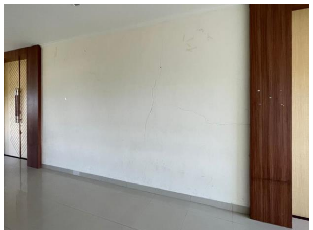
Gambar 4. Dinding Bangunan Mutu Bahan dan Material Bangunan
