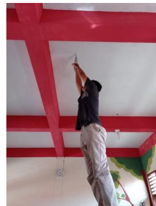
Gambar 15. Pengujian Hammer Test Pada Plat Lantai
