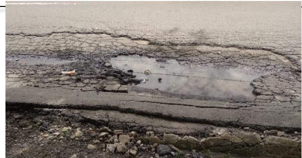
Gambar 2. Kerusakan Jalan di Jalan Raya Kuranji (Sumber: Hasil Observasi, 2022)
