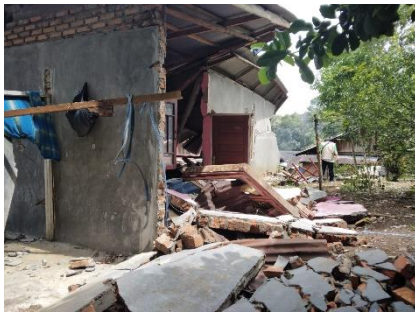
Gambar 2. Kerusakan tipikal dinding roboh
