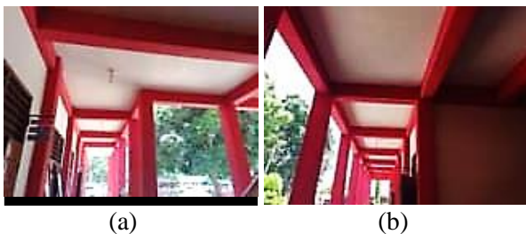
Gambar 6. Struktur tidak mengalami kerusakan Pasca gempa Pasaman 2022
