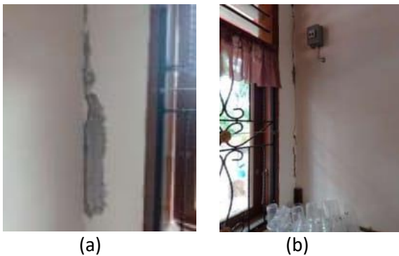
Gambar 5. Kerusakan pada iniding pasca gempa Pasaman 2022
